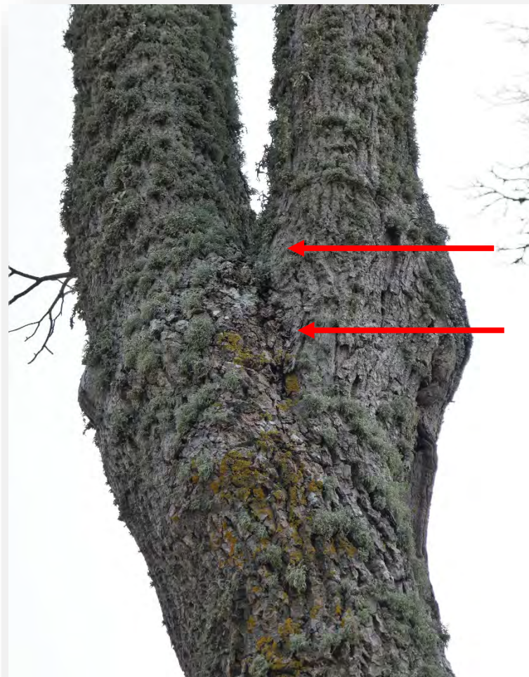
Träd nr 10 – Invuxen bark mellan två större stammar bedöms som en allvarlig defekt.
