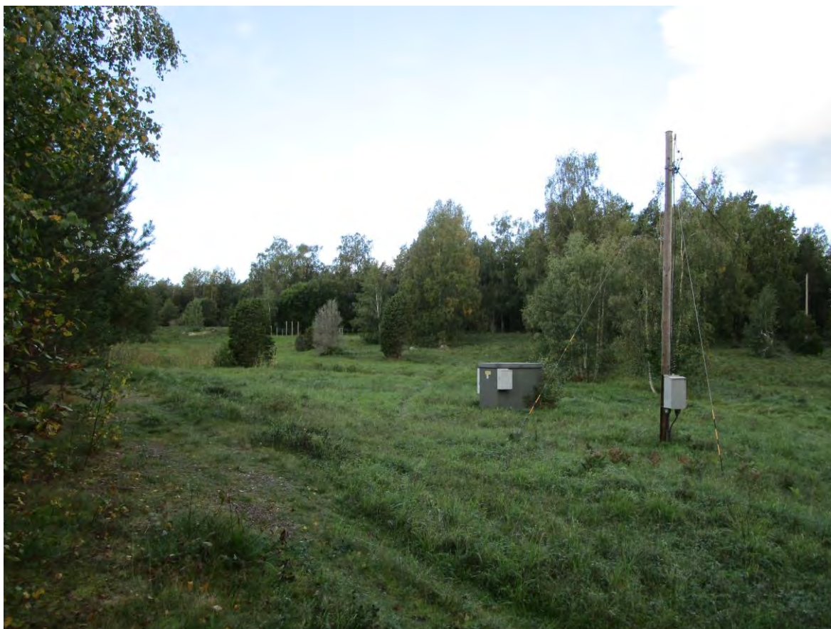
Figur 3. Befintlig transformatorstation och luftledning med stolpe, två stag och mätarskåp 2023-09-14.
