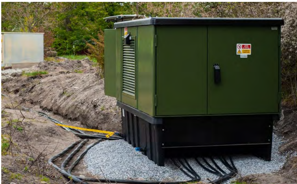
Figur 1. Exempel på en nätstation där ett öppet, mindre schakt och anslutna kablar med lämplig böj ses i direkt anslutning till stationens främre kortsida. Ett fortsatt öppet schakt likt det i bilden bortom stationen kommer dock ej bli aktuellt när schaktfri metod används.
