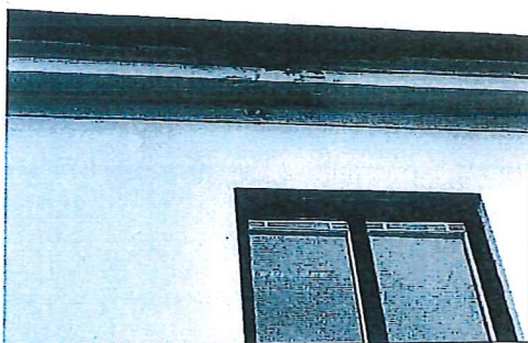
Fuktskada i takfot (under snörasskydd)
