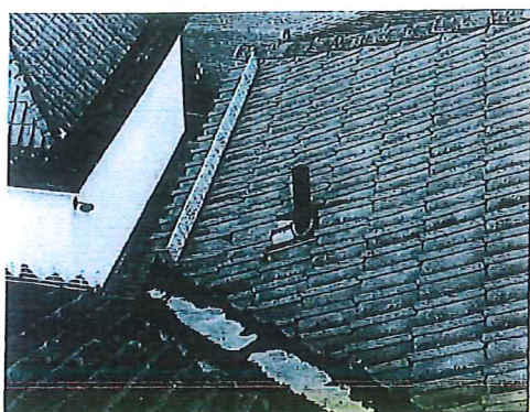
Trasiga takpannor vid rännalar
