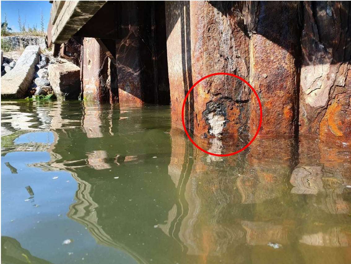
Figur 6. Högra hörnet, från land sett. Inringat i rött är genomrostning, betong syns där det är genomrostat.
