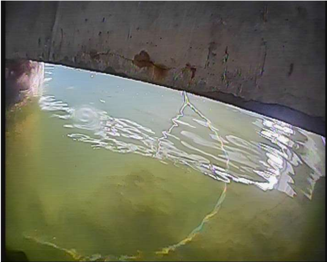
Figur 15. Sprickor och rostgenomslag i tvärbalken längs söderut.
