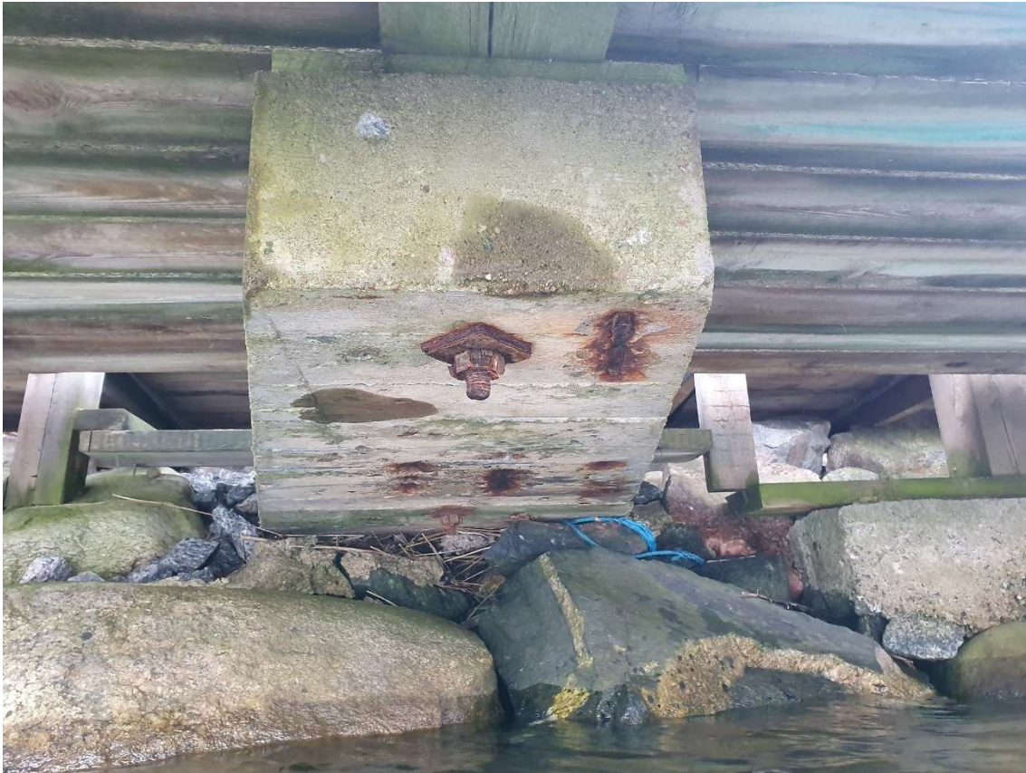
Figur 17. Konsol 7 med rostgenomslag från armering samt fästskruvar för reglar.
