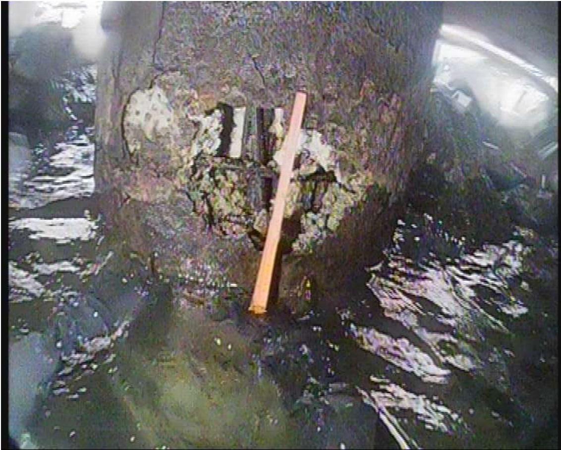
Figur 12. Pelare höger i andra paret inifrån land räknat. Stålröret sönderrostat, betongen skadad.
