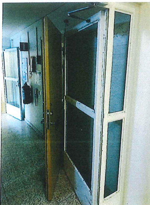
Figur 3 Dörrar som ansluter till trapphuset hindrar varandra.
