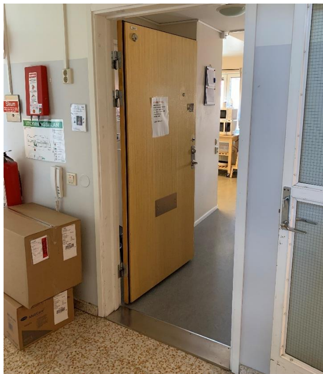
Figur 2 Gemensamhetsutrymme på Bojen som angränsar till det interna trapphuset. Dörren saknar dörrstängare.
