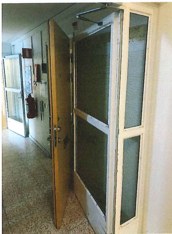
Figur 3 Dörrar som ansluter till trapphuset hindrar varandra.
