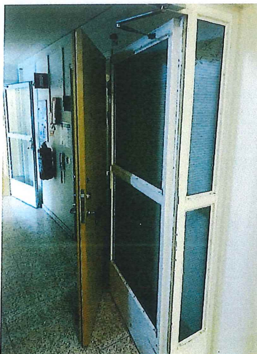
Figur 3 Dörrar som ansluter till trapphuset hindrar varandra.
