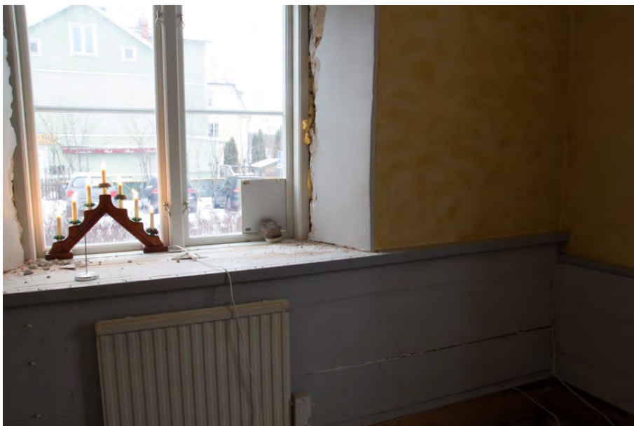
Bröstlsiten på södra och östra väggen skiljer sig åt och ligger på olika nivåer.
