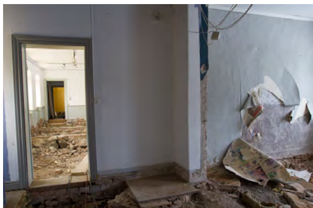
I innerhörn finns fundament till kakelugn i anslutning till en riven innervägg som finns med på uppmättningsritningen från 2009.
