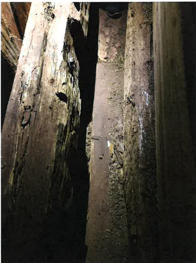
Bild 3: Delar av hjärtstocken och golv med omfattande rötskador. Foto oktober 2021.
